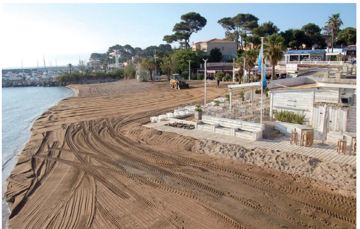
Les travaux de réensablement menés durant quinze jours au début juin auront permis à la plage de La Galiote de retrouver une physionomie plus conforme à ce qu'elle fut par le passé...
