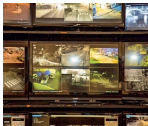
Le Centre de supervision urbain (CSU) relaie les images des caméras disséminées sur le territoire communal
