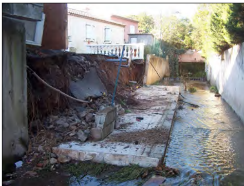
Le mur s'est effondré créant d'importants dégâts dans les habitations limitrophes.
