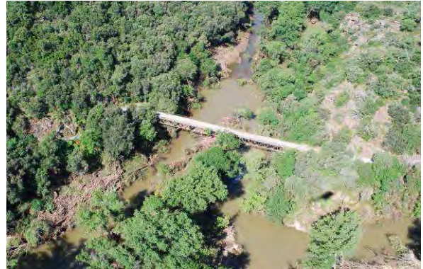
Photos 53 : Pont sur l'Aille à la confluence avec l'Argens - vue post crue
