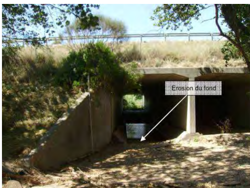
Photos 24 : Passage inférieur sous l'A8 à Roquebrune - trace d'érosion et de mises en vitesses - Source EGIS eau
