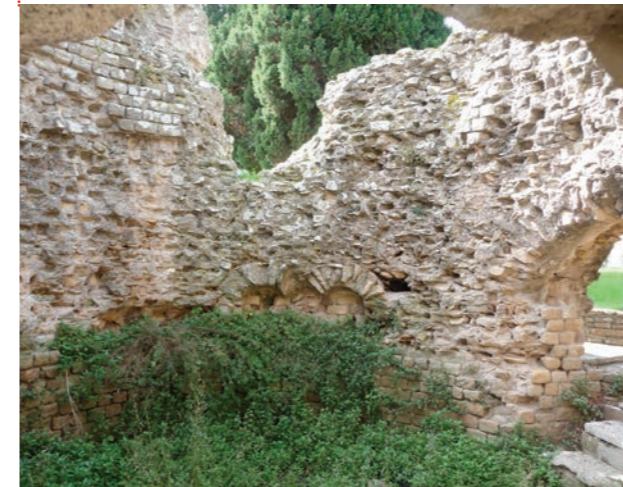
Alvéoles dans les maçonneries
