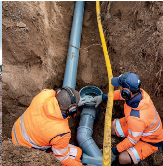
Modernisation des réseaux de distribution destinée à réduire les déperditions en eau potable engendrées par les fuites et la vétusté des installations.
