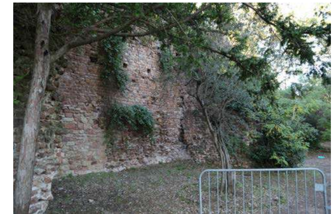
Murs de soutènements aux contreforts massifs autour de la Plate-Forme, au Nord-Ouest du port
